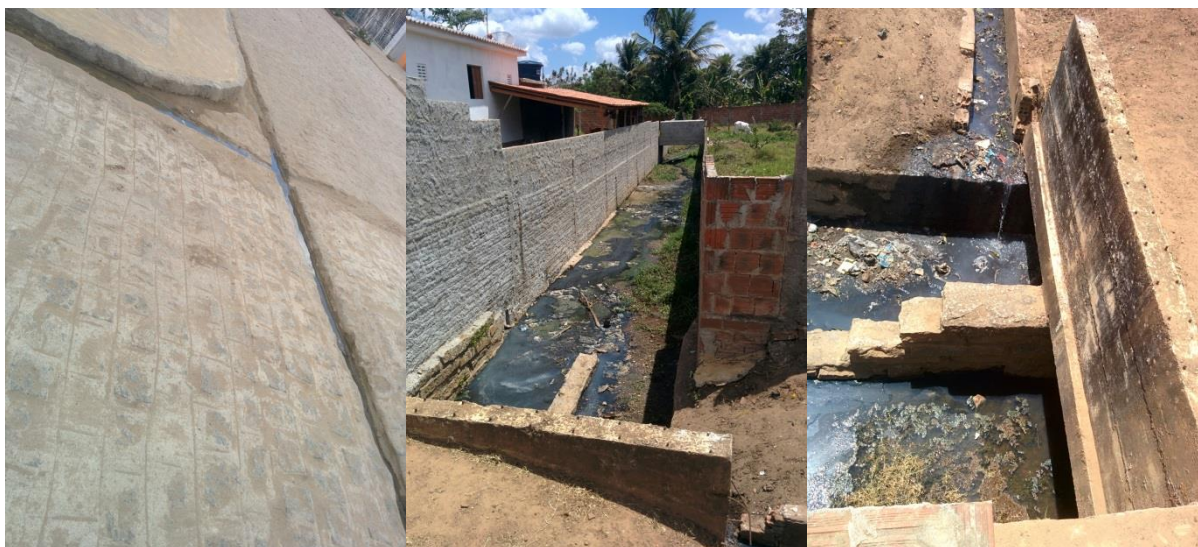
Figura 49. Drenagem pluvial em canal sob pavimentação de rua.
