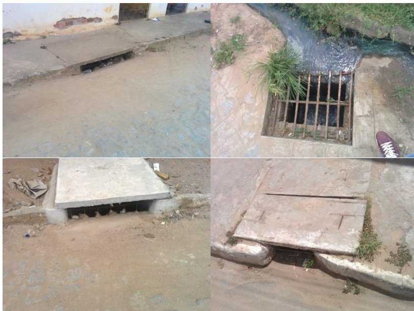
Figura 51. Equipamentos de drenagem de Itapororoca.
