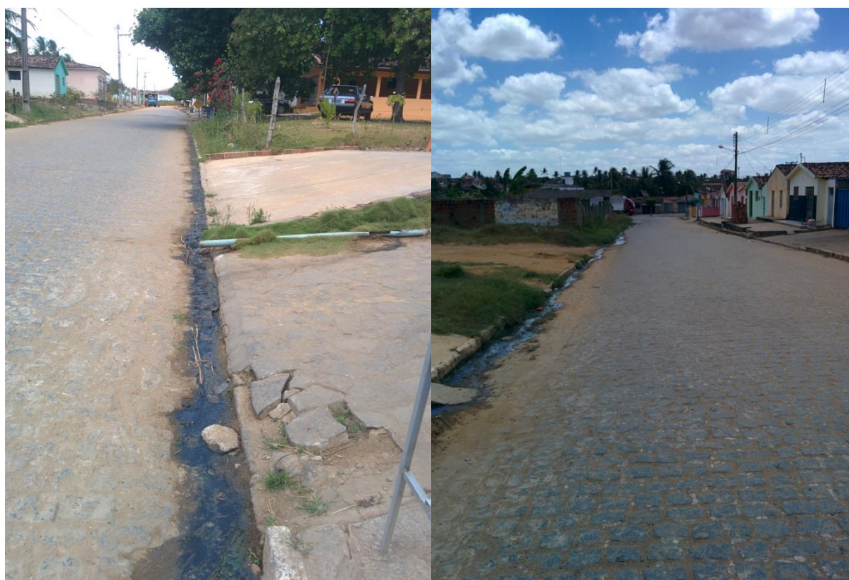
Figura 47. Pontos de lançamento de águas servidas nas vias públicas.
